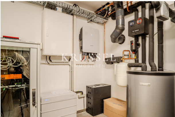
Der Technikraum mit Heizungsanlage
