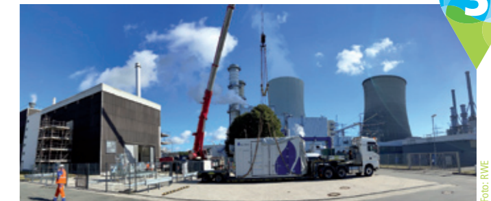
Der mit einem 300-Kilowatt-Elektrolyseur erzeugte Wasserstoff dient dazu, in einer Testpipeline den Transport in Bestandsleitungen der Erdgasinfrastruktur zu erproben.
